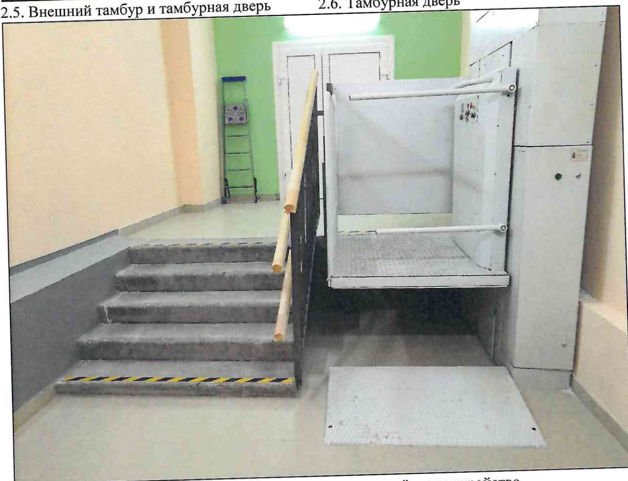
2.7. Внутренний тамбур, лестница и подъёмное устройство
